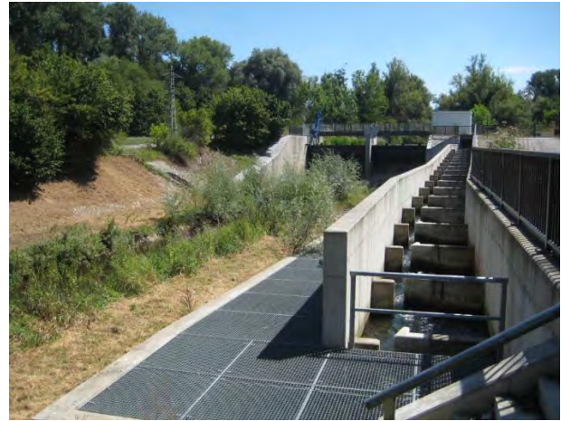
Abb. 20: Fischtreppe an der Pfinz zwischen Söllingen und Berghausen
